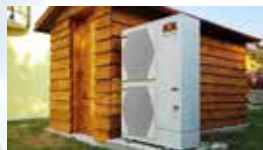
Impianti pompa di calore
