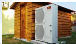
Impianti pompa di calore
